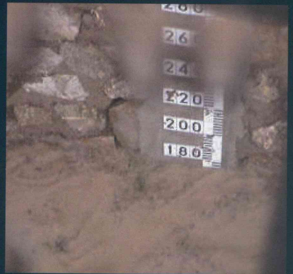
Contraste de Niveles por CCTV ( CCTV level contrast )
