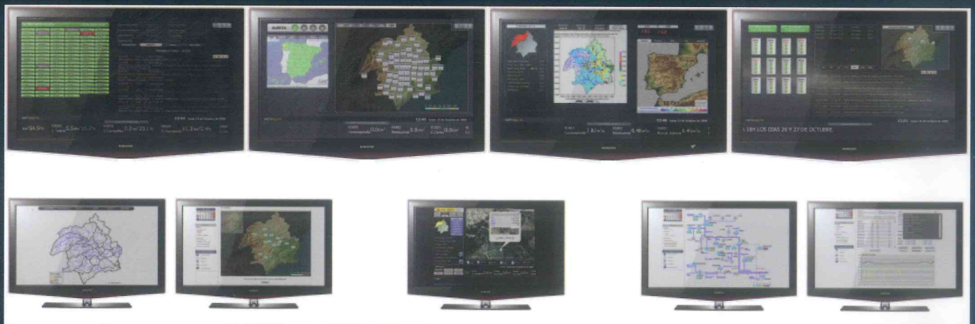
Puesto de Control SAIH Segura ( SAIH Segura Control Station )
