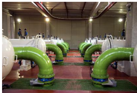
Desaladora de Valdelentisco
