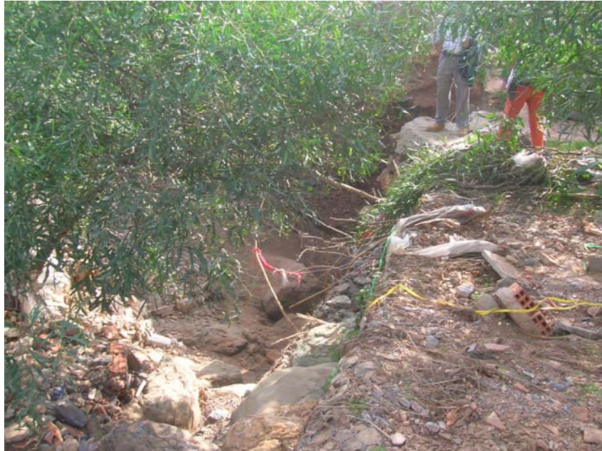
Fotografía 7: Erosión aguas abajo de la albarrada
