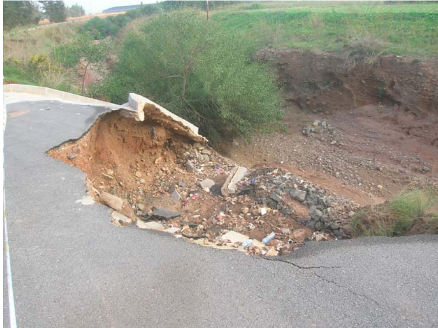
Fotografía 5: Efectos de la erosión en la cabeza del talud.
