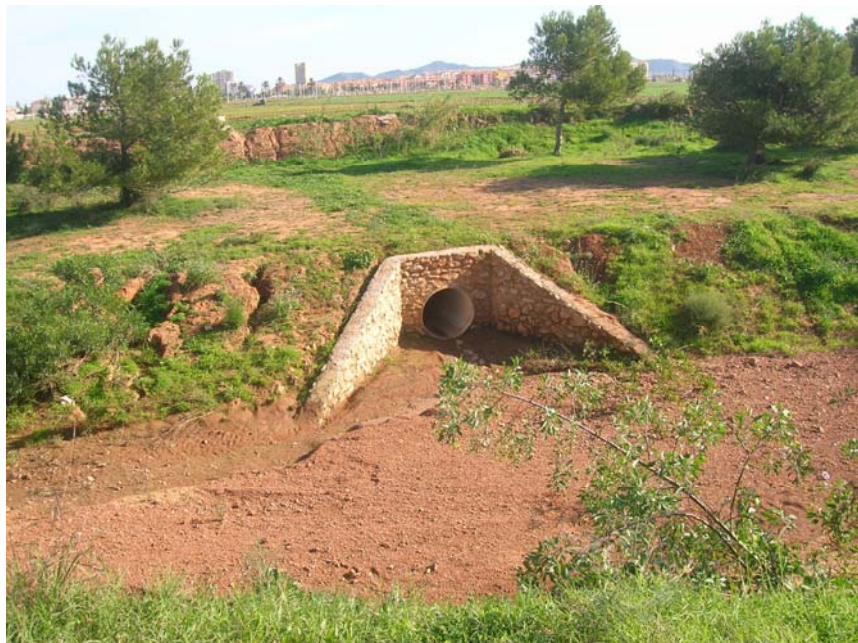
Fotografía 13: Colector de pluviales
