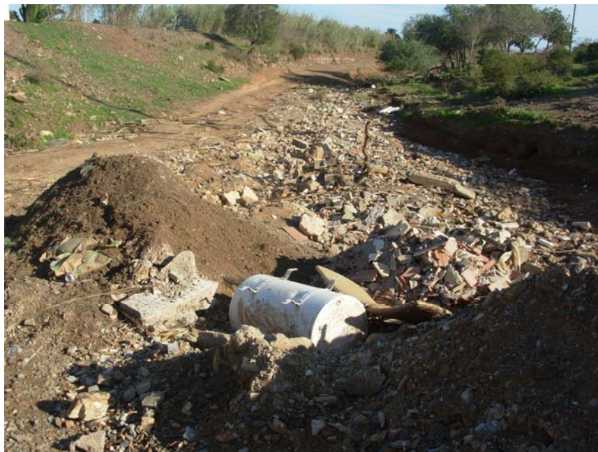
Fotografía 2: Escombros asociados al paso del camino
