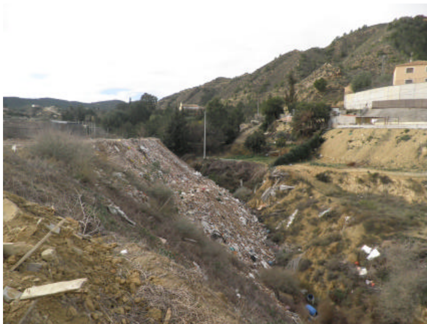
Figura 8: Vertedero en rambla de los Puros, afluente de la rambla del Garruchal por su margen izquierda.
