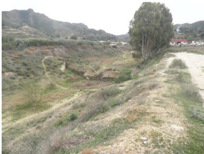
Figura 14: Tramo final: Restos de dique colmatado.
