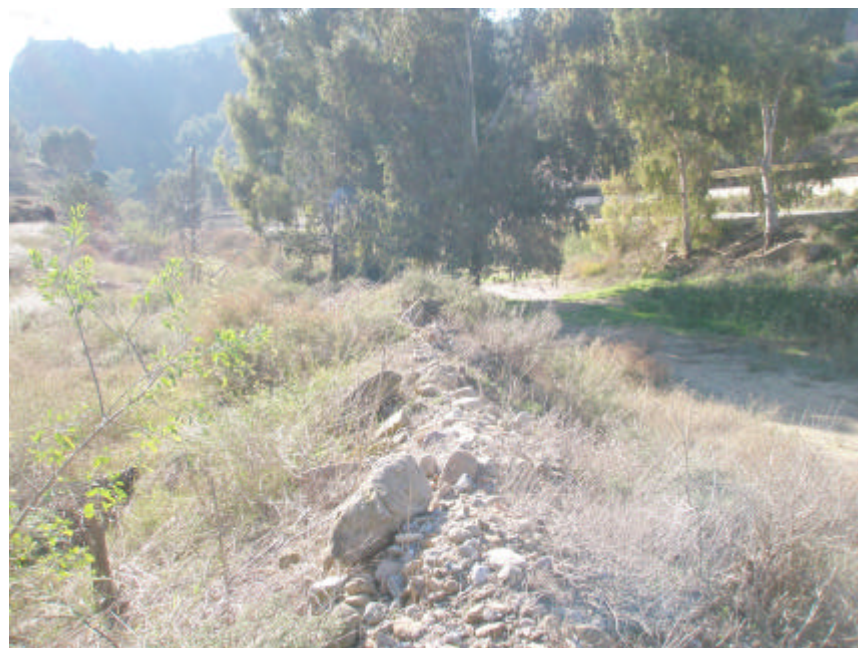
Figura 12: Mota lateral tramo boquera de Tiñosa. Desconexión de las márgenes con el cauce.
